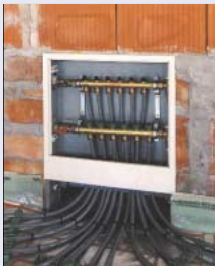
12 Prosty rozdzielacz pętli grzewczych, wbudowany w szafkę wnękową
