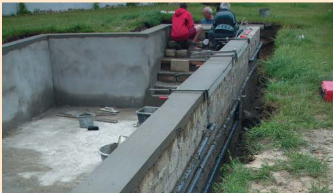
▲ Po wymurowaniu niecki należy ją otynkować wewnątrz i osadzić niezbędne elementy (skimery, przejścia przez mur, reflektory, itp.) oraz wykonać instalacje basenu
