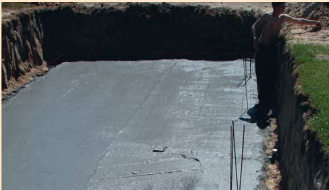
▲ W wykopie należy zrobić podsypkę żwirową oraz wykonać siatkę zbrojeniową na dnie, w tym momencie osadza się spust denny oraz wyprowadza zbrojenie na trzpienie
