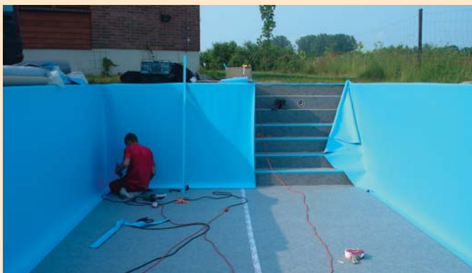
▲ Nieckę w środku wykłada się najpierw geodezyjną wykładziną, następnie krawędzie niecki pokrywane są listwami, do których przez zgrzanie mocuje się folię (ostateczne wykończenie niecki). Następnie można montować w niecce: reflektory, dysze, skimery, itp. oraz napełniać stopniowo basen wodą
