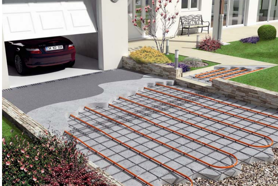
▲ Ogrzewanie przeciwołdzeniowe można zastosować do nawierzchni kamiennych, ceramicznych, betonowych i asfaltowych
